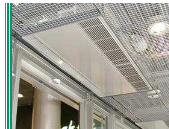
VENTILACIÓN ROOF TOP
